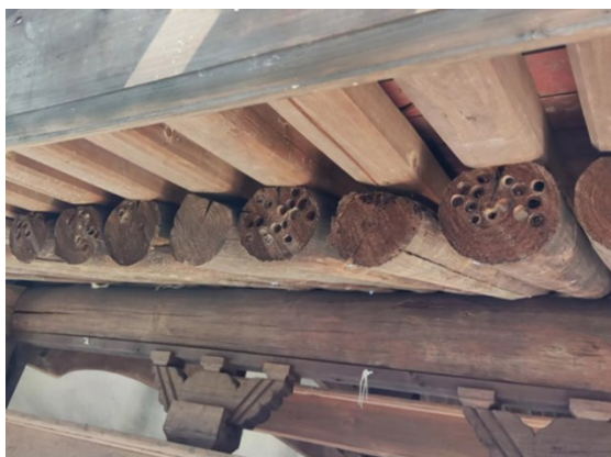
图1 木蜂危害的木结构建筑(浙江省宁波市宁海县深甌镇永丰庙戏台)
